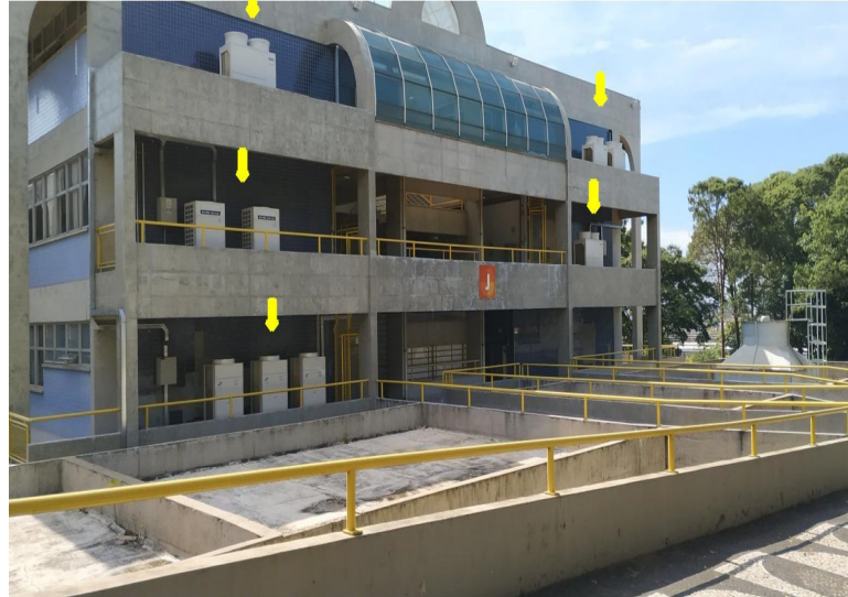
Figura 33 – Novos aparelhos de ar condicionado - Blocos J e K (Hitachi)
