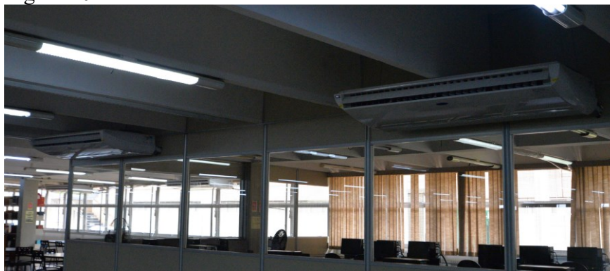
Figura 10 - Ar-Condicionado instalado na Biblioteca
