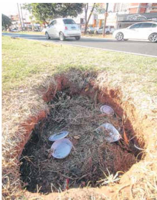
Próximo da Praça da Paz, outro buraco se formou no canteiro central da avenida
